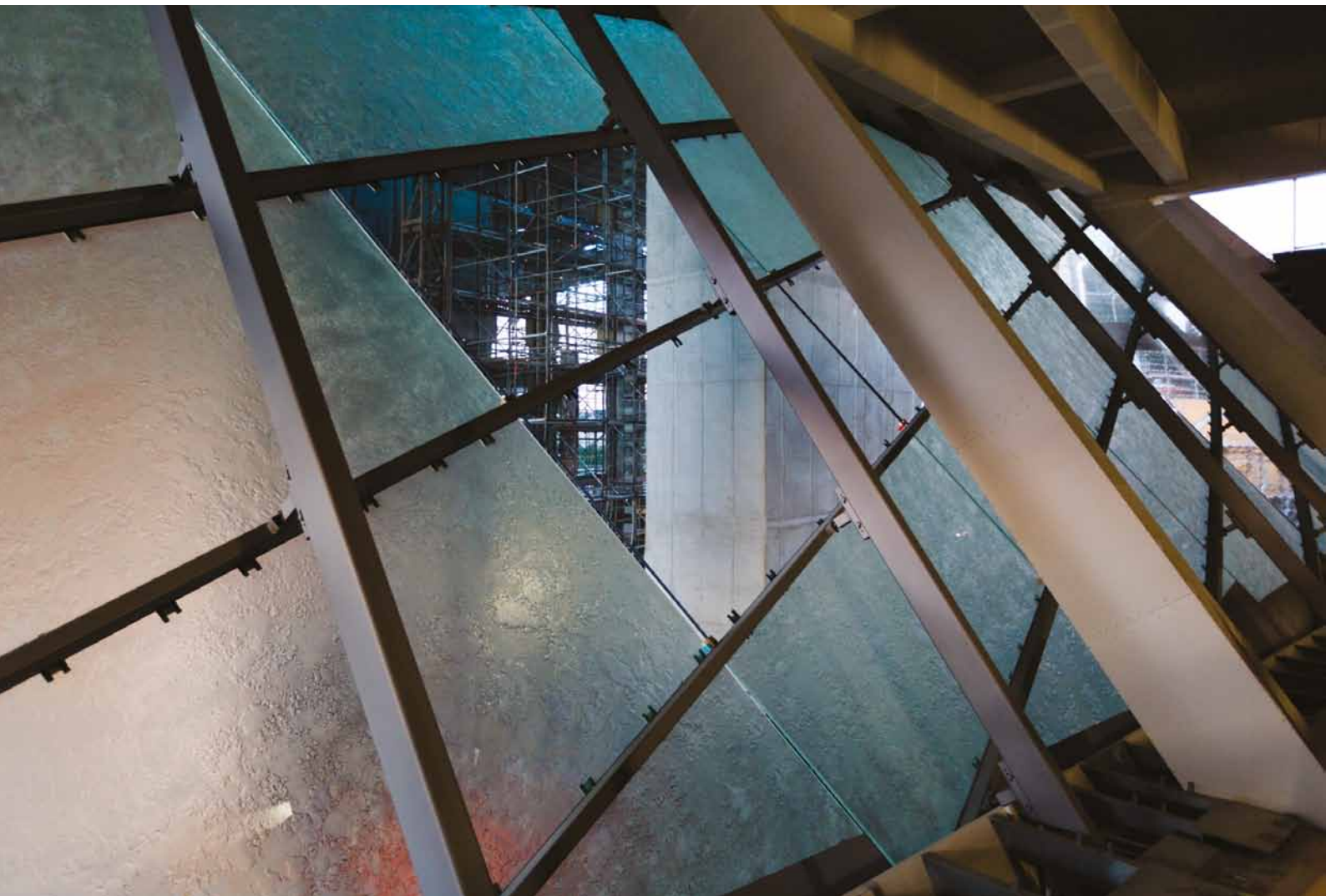
A fachada interior leste do edifício de entrada, que separa o centro de imprensa do átrio principal, consiste em painéis de vidro translúcido montados numa estrutura de aço concebida para o efeito. A translucidez dos painéis de vidro é obtida através de um tratamento com jato de areia.
